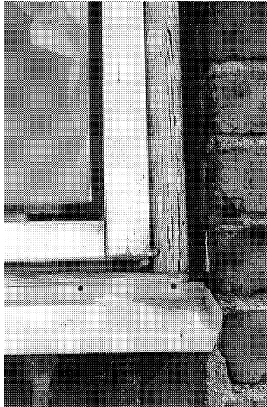
Figur 8.21 Detalj av fönster nr 3 som visar på ett hårt slitage av ytbehandlingen.
